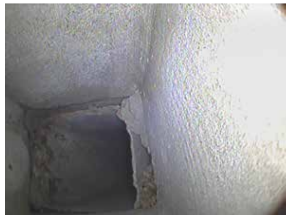
Eternitkanal före tätning
