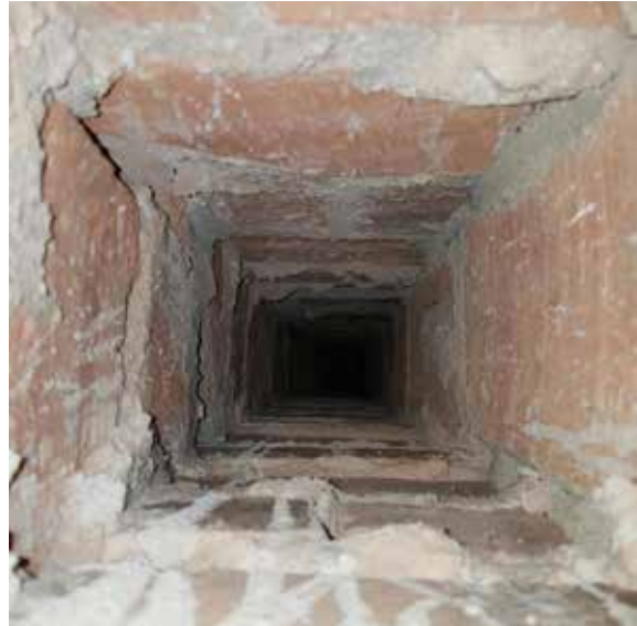
Tegelkanal före tätning
