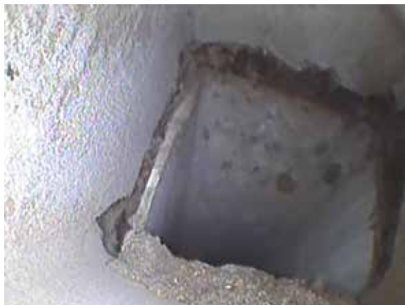
Eternitkanal med väl synliga hålskador
