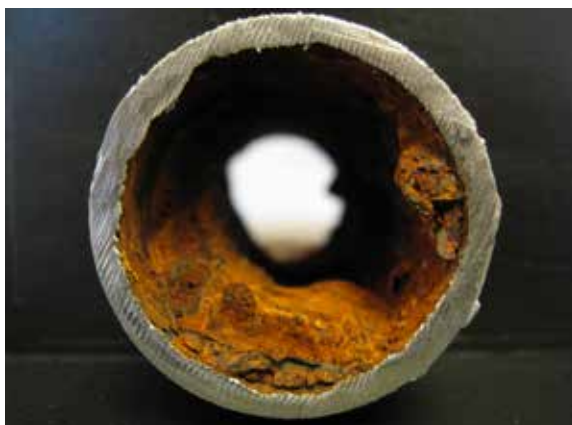
Rostiga rör kan ha kraftigt försämrade vattenflöden.
