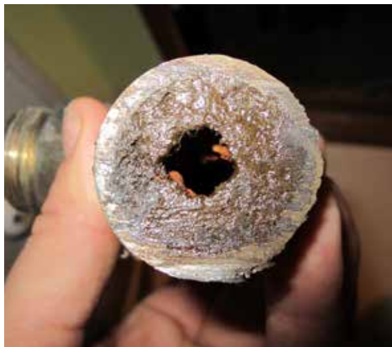
Tvärsnitt av ett igenrostat vattenrör.
